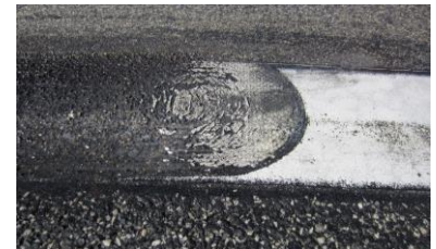
(Abb. 2: Beschädigung Standard-HDW)
